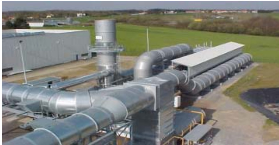
Figura 6: Assieme standard della camera di combustione e relativa panoramica impiantistica di un RTO da 250.000 Nm 3 /h con torri rigenerative in linea ad elevato DRE (Destruction and Removal Efficiency).
