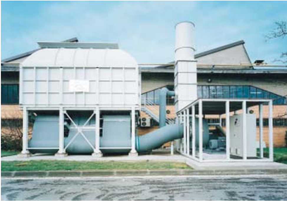
Figura 4: RTO con letti ceramici per il trattamento emissioni HAP (Hazardous Air Pollutant) dell'industria serigrafica.
