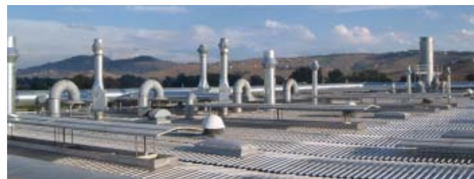
Sezione impiantistica dedicata alla captazione dell'aria inquinata proveniente dalle cabine di verniciatura a liquido
