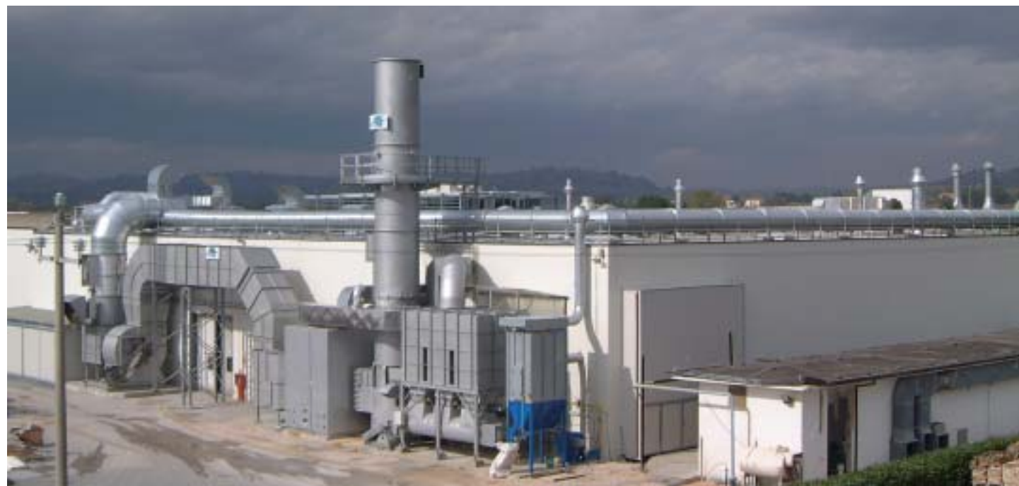
L'impianto di abbattimento solventi ITAS
