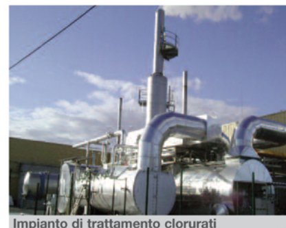
Impianto di trattamento clorurati
