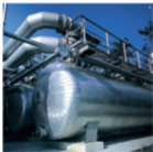
1 Impianto a gas per solventi e carboni attivi. Attivo carboni solvent recovery system.
